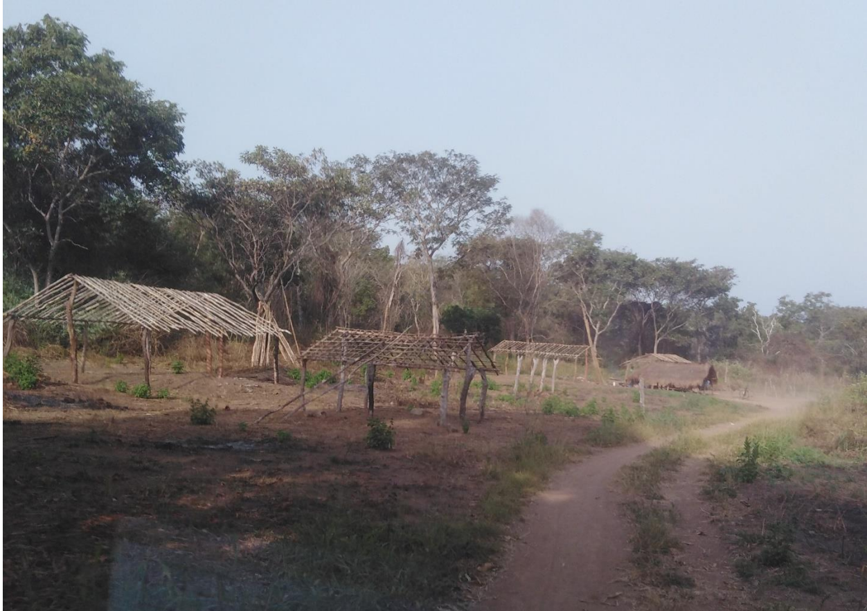
Construction des abris traditionnels pour des éventuels retours des déplacés, axe Bria - Aigbando, 2020. © OCHA / Ghislain Djima Djarade
